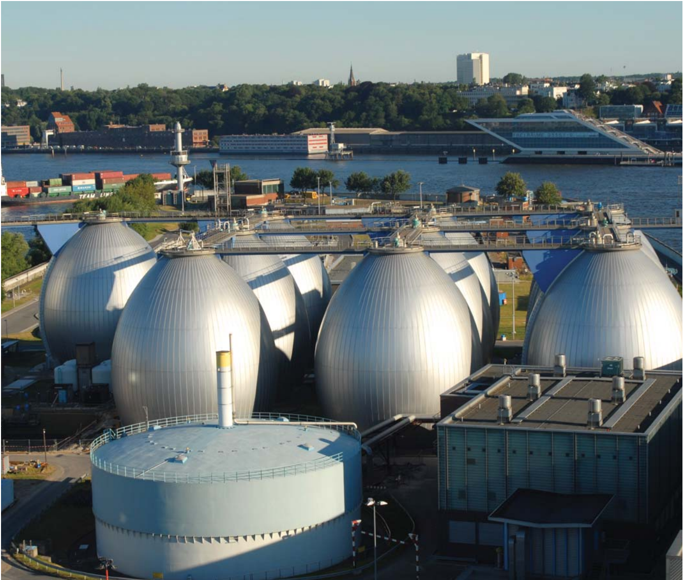
Vorbild für effektive Nutzung der Ressourcen: In den Faultürmen im Hamburger Hafen werden Gase des Klärschlammes zur Energiegewinnung verbrannt. (Foto: Hamburg Wasser)
